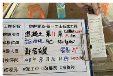
混凝土氯離子試驗
